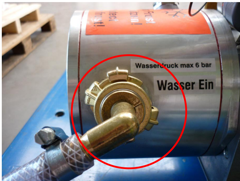
Рис. 4.5: к НFM-11 подключена подача воды
