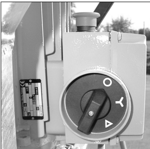
Рис. 4.3 ВКЛ-/ВЫКЛ- (звезда-треугольник-) выключатель и аварийная кнопка (сверху) на электромоторе маслостанции HAG•12.2
