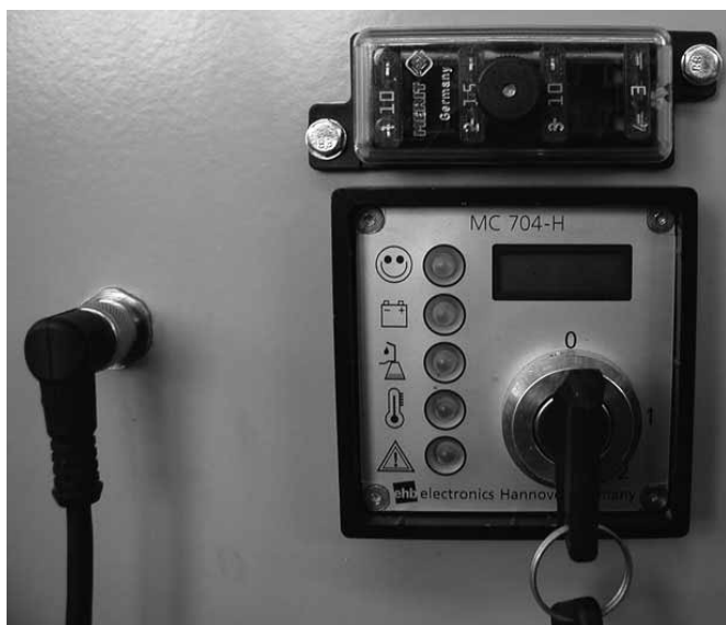
CF-3002 D (стандарт), блок управления двигателем, блок предохранителей (сверху), штекер для подключения механизма опорного колеса (кнопки)
