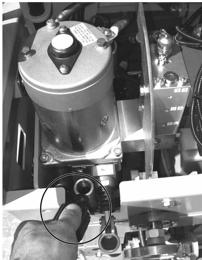
Пульт управления слева, крышка снята, отвинчена крышка маслосливной горловины на электрогидравлической компактной маслостанции
