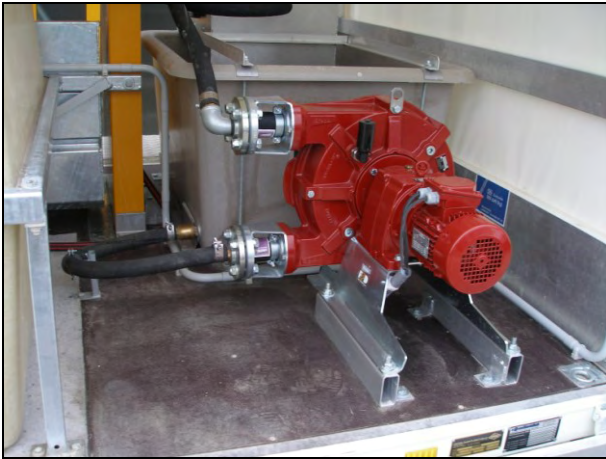
Рис. 3.1: Буферная ванна с насосом грязной воды
